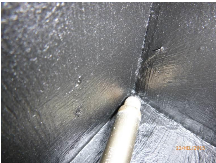
Kuva 4. Vähäinen vuoto havaittiin testikappaleen sisänurkasta.
